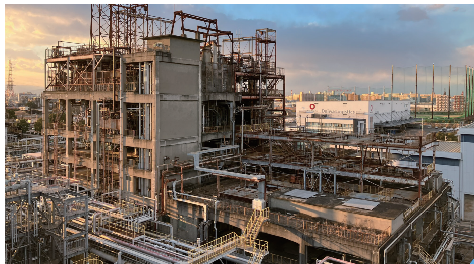
東レ名古屋事業場 ケミカルリサイクル設備(建物内の一部に設置)
